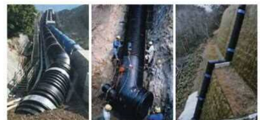
急傾斜(露出)配管
