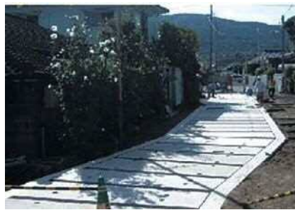
CTGスラブを使用した水路蓋
