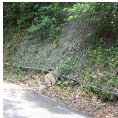
落石防護網裾のこぼれ出し状況
