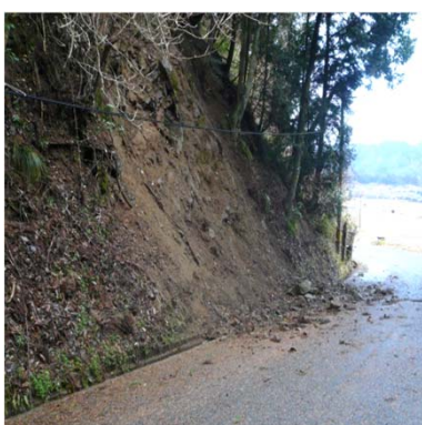
施工前：斜面崩壊
