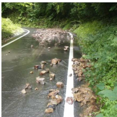
小規模落石の状況
